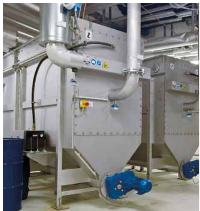
Kommunales Abwasser; 2x RoWin BG8; therm. Entzugsleistung 560 kW Heizen / 1.000 kW Kühlen.
