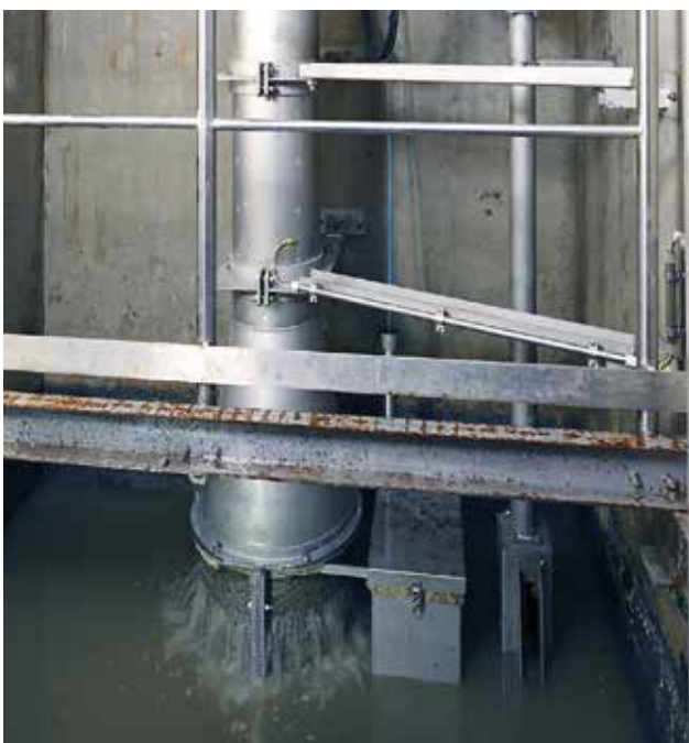
Vorsiebung im Entnahmebauwerk mittels einer HUBER Schachtsiebanlage ROTAMAT® RoK4.
