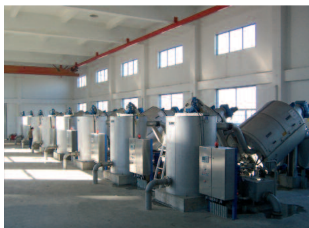
多台污泥浓缩装置，处理量 600 m 3 /h
