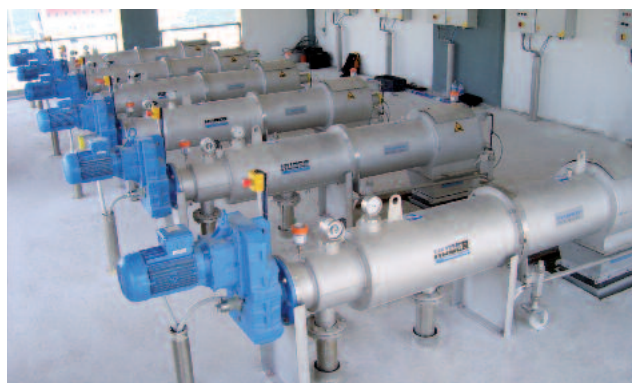
Фильтрация осадка на канализационных очистных сооружениях в Афинах, Греция
