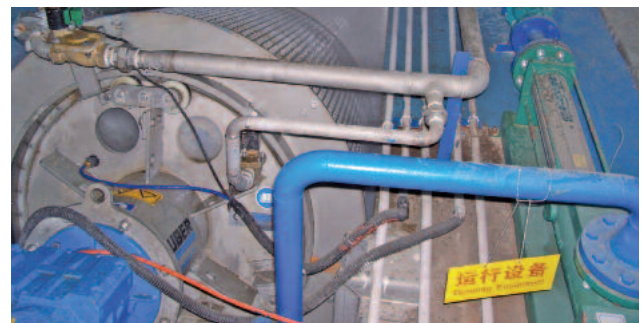
Abförderung des Siebgutes aus der RoMem liquid mit einer Exzentrerschneckenpumpe
