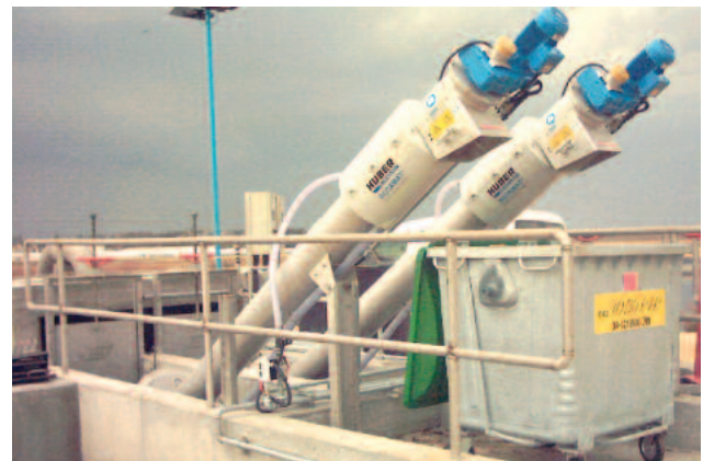
ROTAMAT® Trommelsiebe Ro 2 in Freiluftaufstellung mit Begleitheizung und Wärmedämmung
