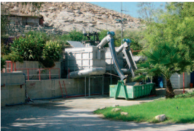
Abwassersiebung mit ROTAMAT® Trommelsieben Ro 2, die mit 2 mm Spaltsieben ausgerüstet sind
