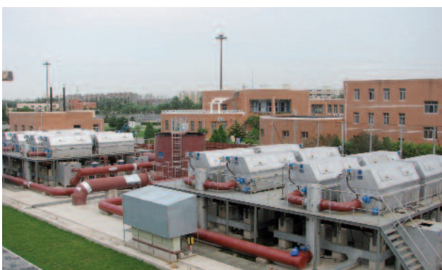
River Outfall in China: 16 Feinstsiebtrommeln RoMesh® mit 0,2 mm Quadratmaschengewebe
