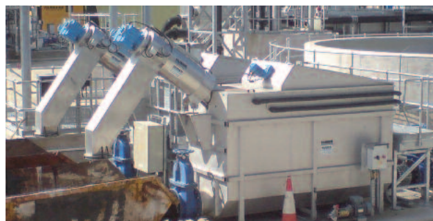
Tamiz de finos HUBER ROTAMAT® RoMem instalado en un tanque contenedor de acero inoxidable.
