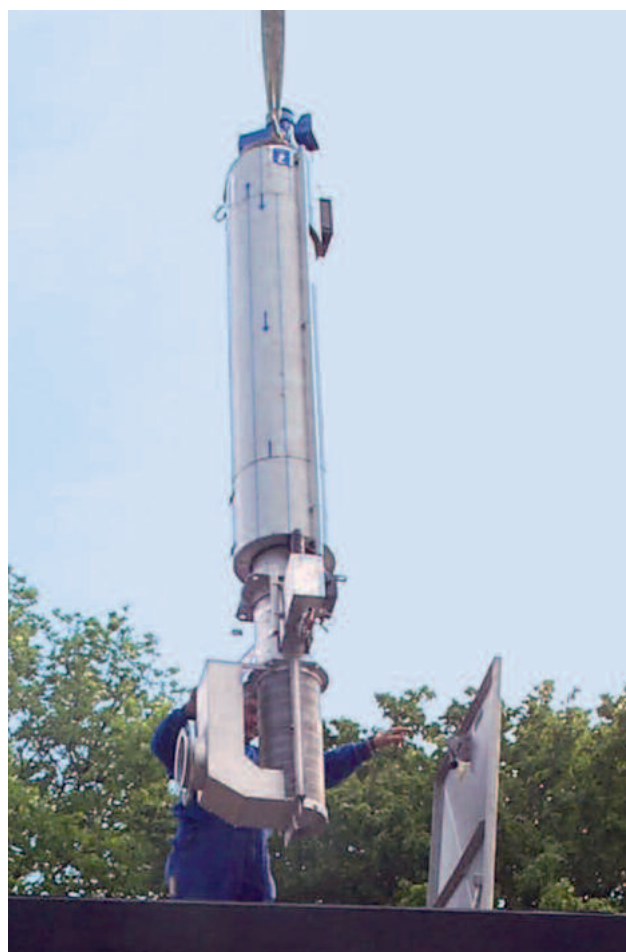
Mise en place d'un dégrilleur vertical ROTAMAT® RoK 4 dans une station de pompage
