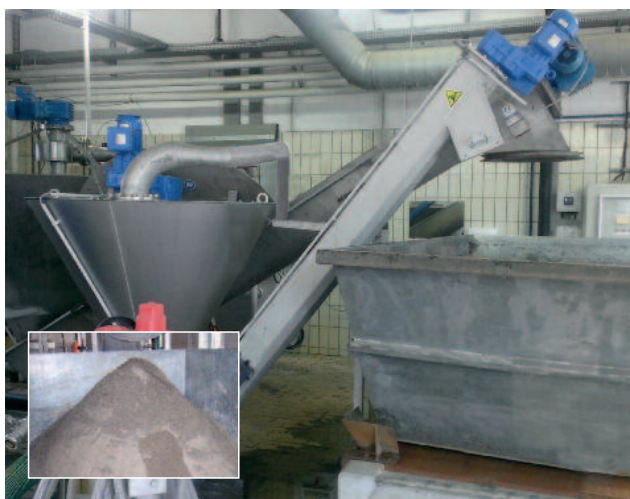
Laveur de sable sur une station d'épuration municipale
