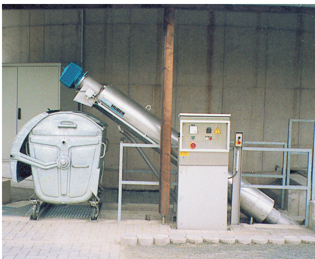
Решетка HUBER ROTAMAT® Ro9, установленная вне помещения
