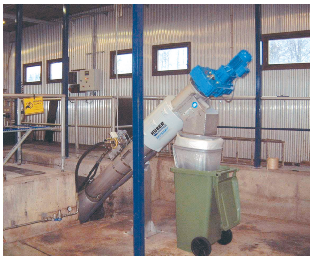
Решетка HUBER ROTAMAT® Ro9 типоразмером 700, установленная в канале
