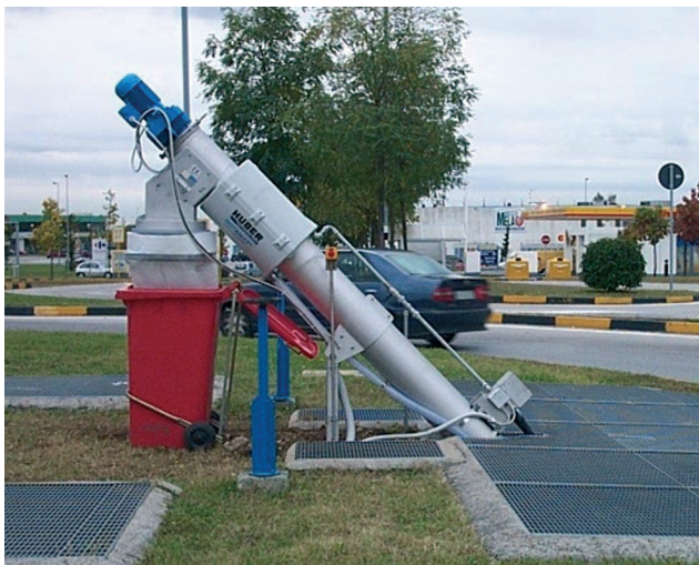
Решетка HUBER ROTAMAT® Ro9 установлена на улице в центре круговой развязки
