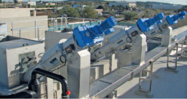
Sistemden sonra gelen membran tesisini koruyan 3 adet RPPS-Star boyut 1000 1.5 mm perfore aralığı ile
