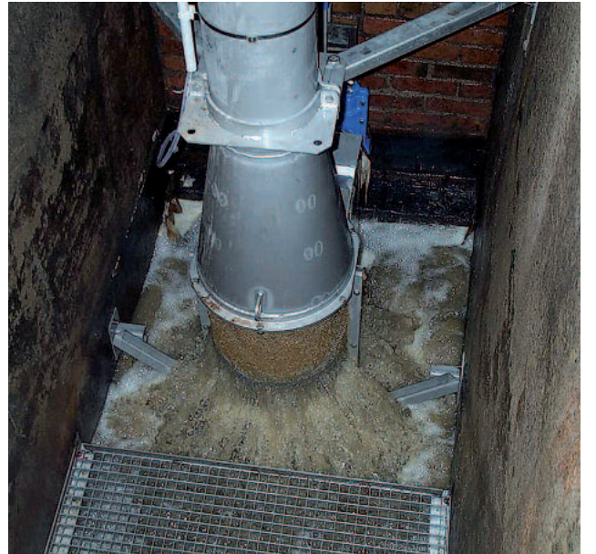
ROTAMAT® Pompa İstasyonu Izgarası RoK 4 çalışırken
